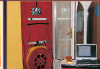
Blower Door System
